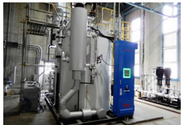
導入したガス焼きボイラ。屋外にはボイラにLPGを供給するサテライト設備も整備した。
